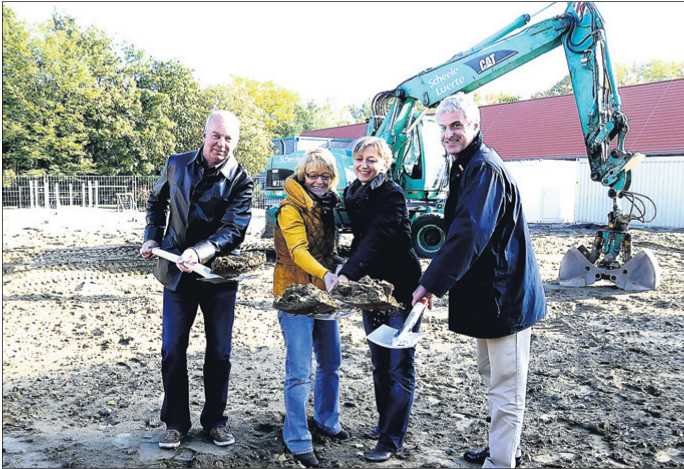
Die neuen Spaten strahlten mit der Sonne um die Wette, als gestern der erste Spatenstich symbolisch vollzogen wurde. Zufrieden zeigten sich dabei Heiner Köster, Ingrid Lutze, Anja Lösch und Bürgermeister Kian Shahidi (von links). • Foto: Dejo
